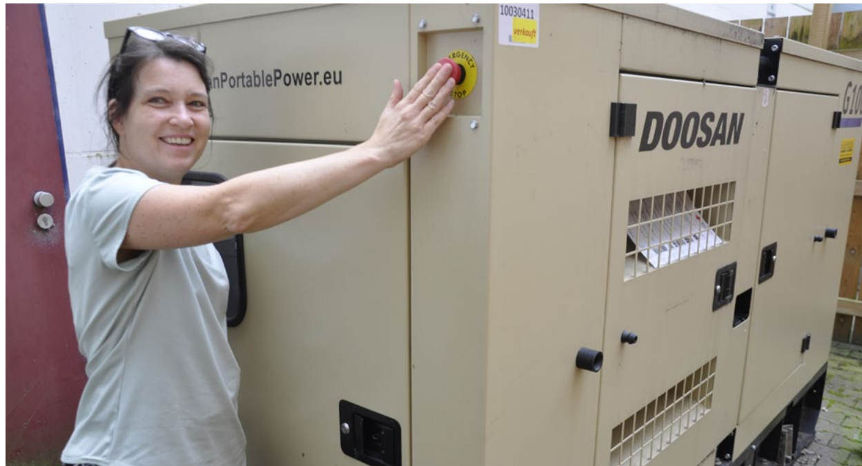
Neueste technische Errungenschaft von DRK Haus Ravensberg ist dieses von Mitarbeiterin Katja Schmidt präsentierte Notstromaggregat.
